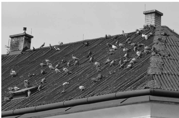
■ Velké hejno zdivočelých holubů na střeše domu v ulici Vodní ve Valašském Meziříčí (Foto K. Pavelka)
