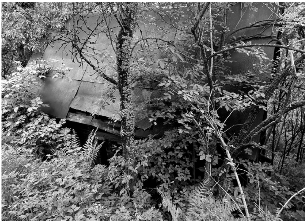
Obr. 6: Sušárna usedlosti v Kršelkách (k. ú. Halenkov, p. č. 6407), náleзовá situace podzim 2019. (Foto: Zdeněk Bill) |
