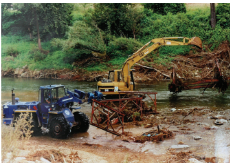
Stržená lávka přes Rožnovskou Bečvu ve Valašském Meziříčí na Křižné, trasa k sokolovně a bývalému kostelu Nejsvětější Trojice (7. 7. 1997) (Foto I. Chumchal)
